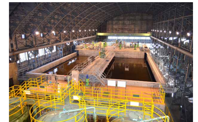
本山坑廃水処理場 (豊羽鉱山)
