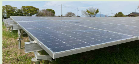
PPA事業者により設置された太陽光発電所の一例
