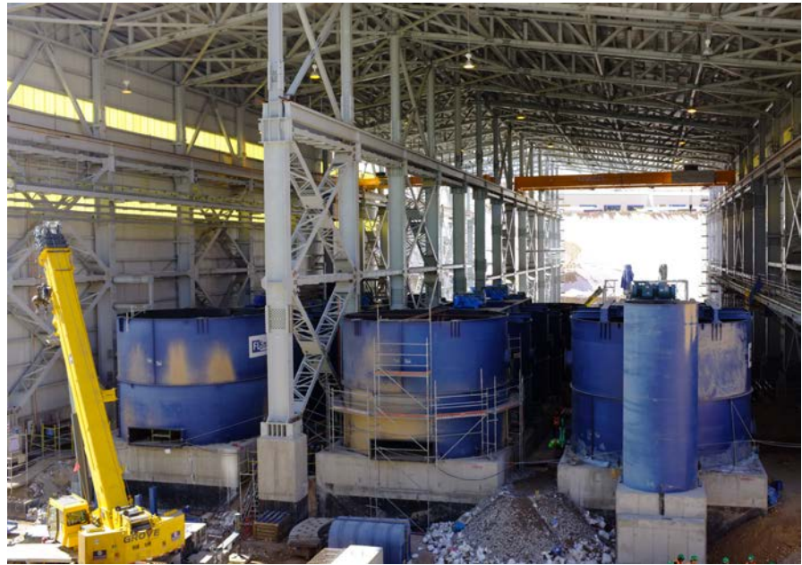
浮選建屋・浮選機
