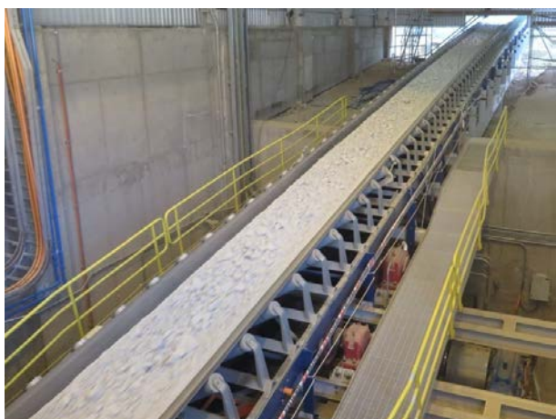
SAG 給鉱コンベア
