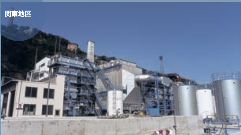
日鉱環境(株)(茨城県日立市)回転式焼却炉
