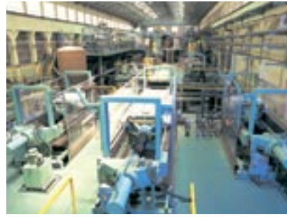
佐賀製錬所の「貴金属・レアメタル回収設備」
