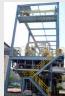
電解液循環設備
