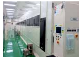
龍潭工場の無電解 UBM めっき加工ライン
