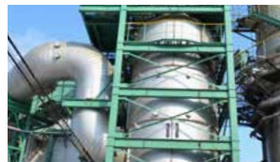
JX金属苫小牧ケミカルの低濃度PCB廃棄物処理設備
