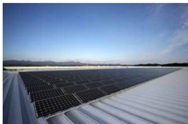
JX金属プレシジョンテクノロジー掛川工場の太陽光パネル
