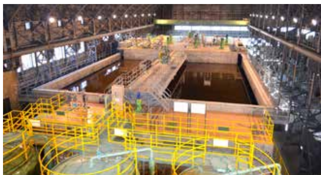
豊羽鉱山 本山坑廃水処理場の様子
