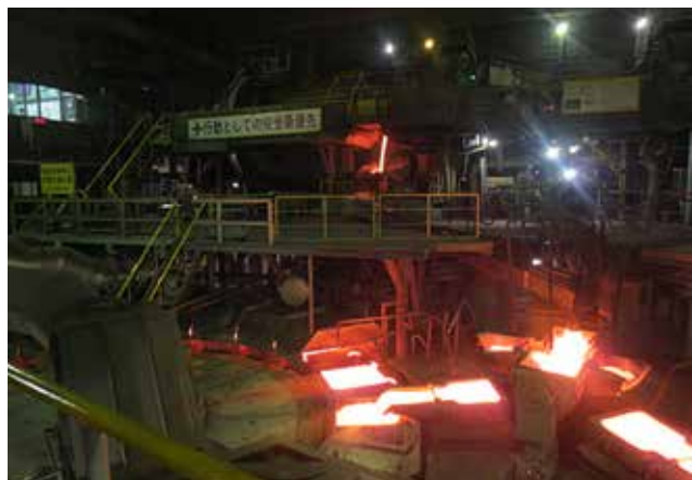
LED照明にさし替わった現場（パンパシフィック・カッパー佐賀製錬所）
