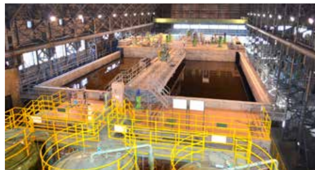
豊羽鉱山 本山坑廃水処理場の様子
