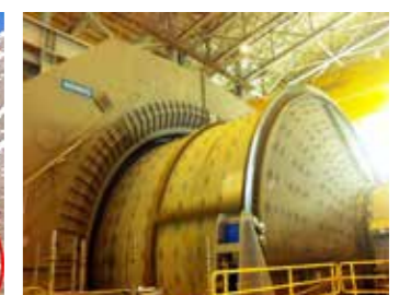
SAGミル(磨鉱機) 破砕設備で200mm以下となった鉱石を磨鉱工程で0.2mm程度まですりつぶす
