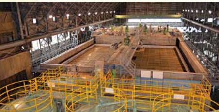
豊羽鉱山(北海道)の本山坑廃水处理場の様子
