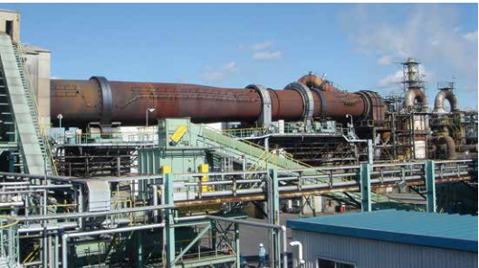
J X金属苫小牧ケミカル(株)のロータリーキルン式焼却炉
