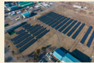
PPA事業者により設置された太陽光発電設備
