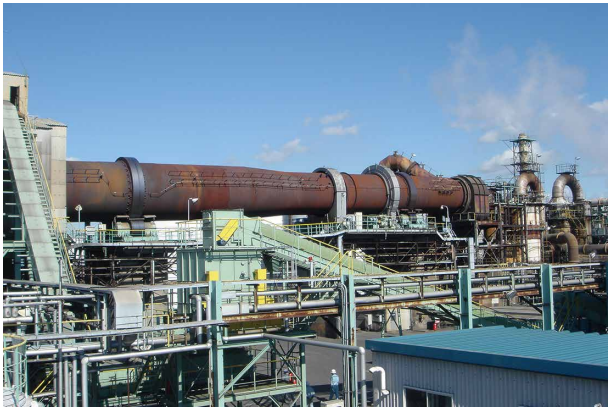
J X金属苫小牧ケミカル(株)のロータリーキルン式焼却炉
