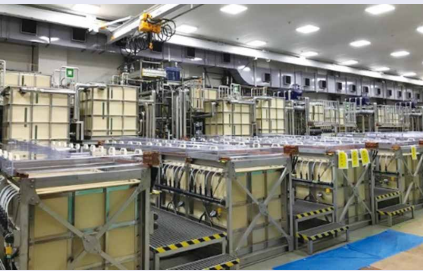
半導体用スパッタリングターゲットの設備、電解槽 (磯原工場)
