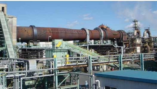
J X金属苫小牧ケミカル(株)のロータリーキルン式焼却炉
